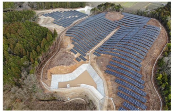
写真-2 エネ・シード京都南丹太陽光発電所
