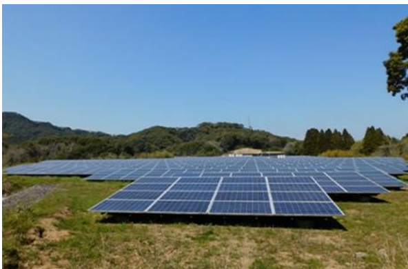
写真-1 エネ・シード都城太陽光発電所
