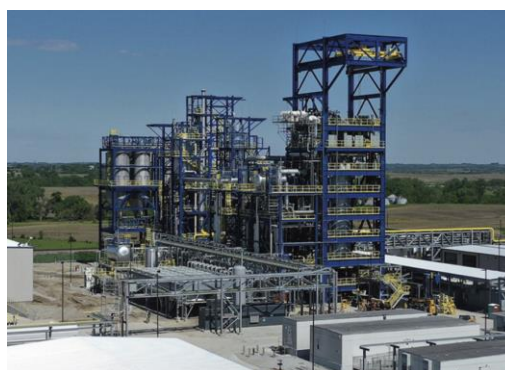
米国ネブラスカ州にて運転中の商用規模プラント
