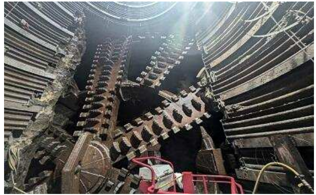
羊蹄トンネル（比羅夫）（ニセコ町・倶知安町） 中間立杭マシン面版
