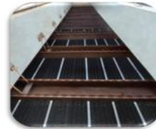
傾斜板式沈殿装置 (ラメラセパレータ)
