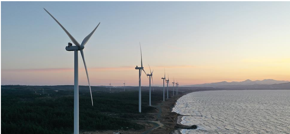
図-4 野辺地陸奥湾風力発電所
