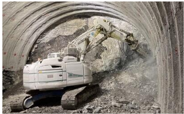
渡島トンネル(南鷺)(北斗市・厚沢部町) トンネル掘削状況
