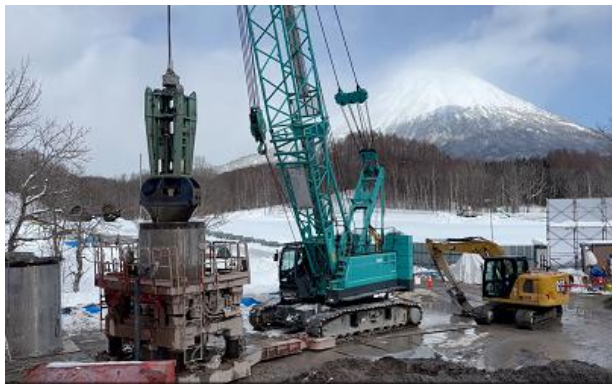
羊蹄トンネル(有島)(ニセコ町) マシン停止位置付近地上部岩塊撤去状況
